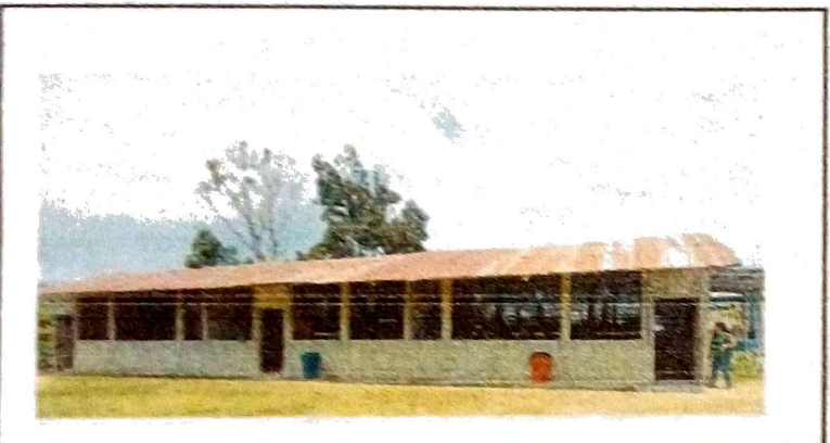
Foto 3: Se observa el deterioro de las láminas.
