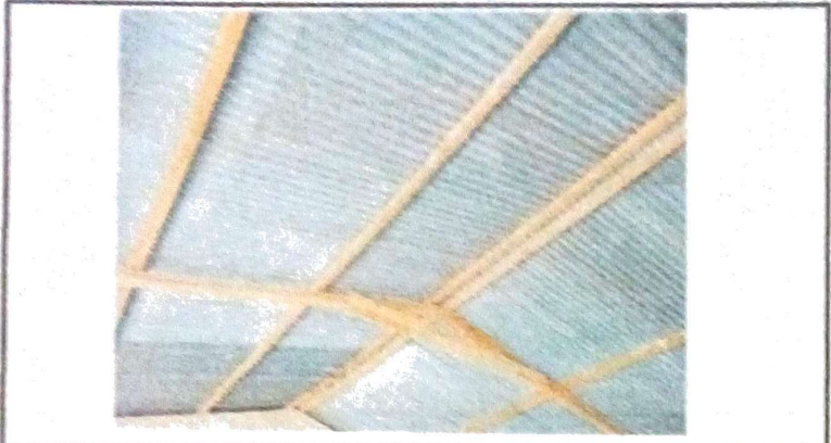
Foto 1: Se observa el deterioro de las costaneras y las tijeras.
